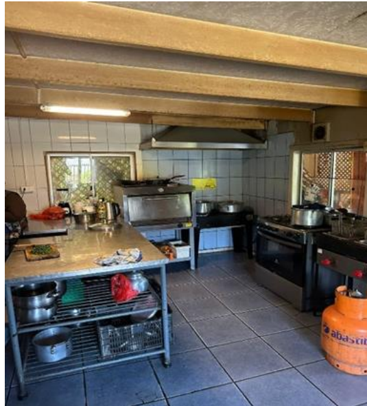
ILUSTRACIÓN 8: COCINA RESTAURANTE "EL RINCÓN DEL ABUELO"
