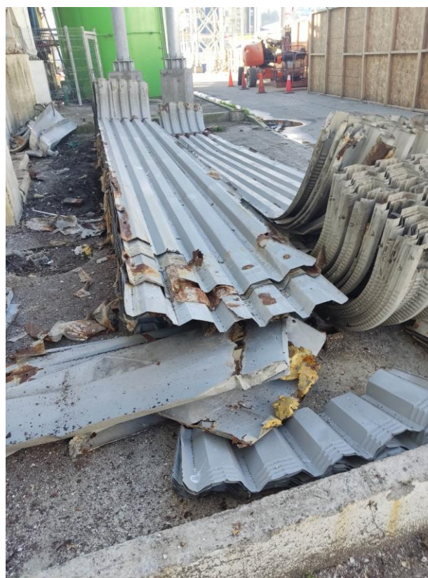
Imagen 8. Cubierta en malas condiciones retirada de Planta de Congelados.
