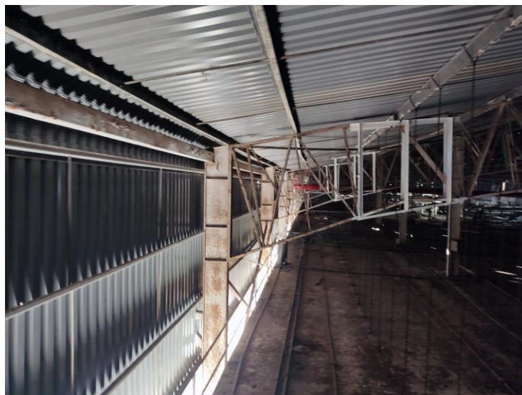
Imagen 9. Oxidación superficial de la estructura de cubierta Planta de Congelados.
