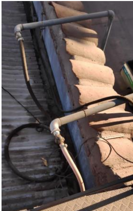
Figura 18. Parte del sistema de piping expuesto al sol.
