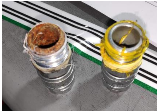
Figura 32. Conexión que se cambió debido a presencia de oxido.
