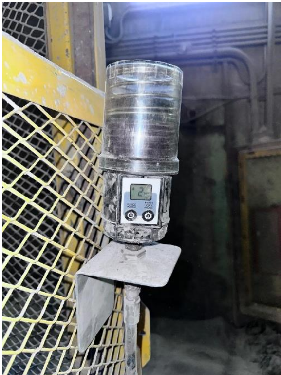
Figura 6. Lubricador automático instalado en la correa transportadora CM1-A para el suministro continuo y controlado de lubricante durante la operación
