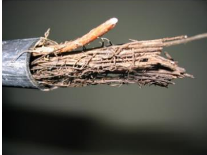
Figura 1-20: Raíces en el interior de líneas de riego
