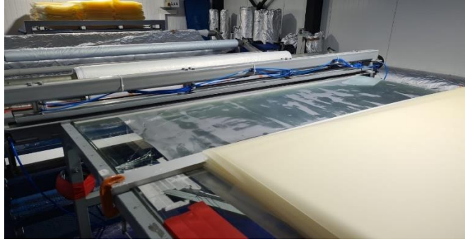
Figura 3-7. Zona de carga PVB
