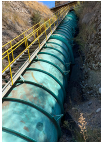
Figura D.7: Tubería de Aducción.
