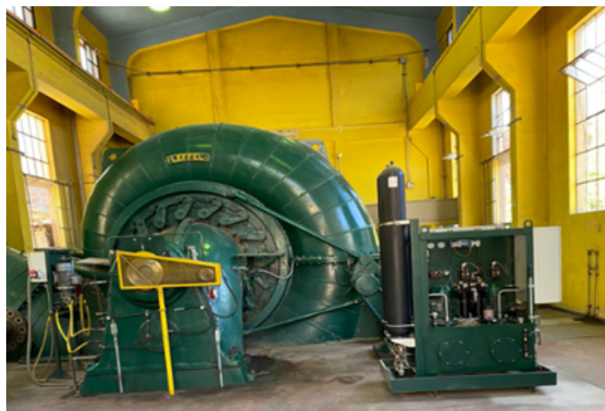
Figura D.2: Máquina Turbina - Generador.
