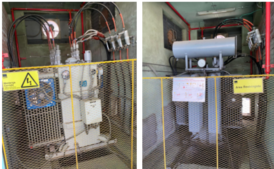
Figura D.8: Transformadores.
