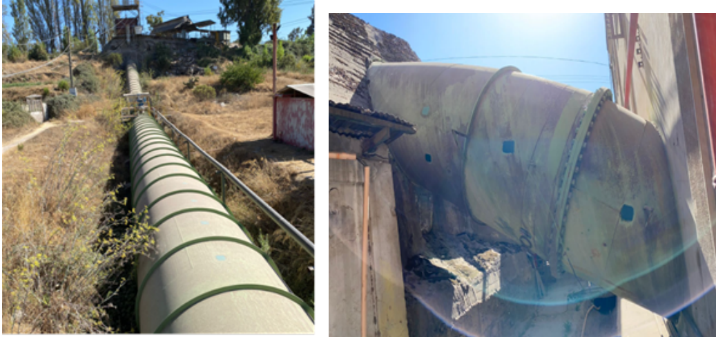
Figura D.3: Tubería de Aducción.
