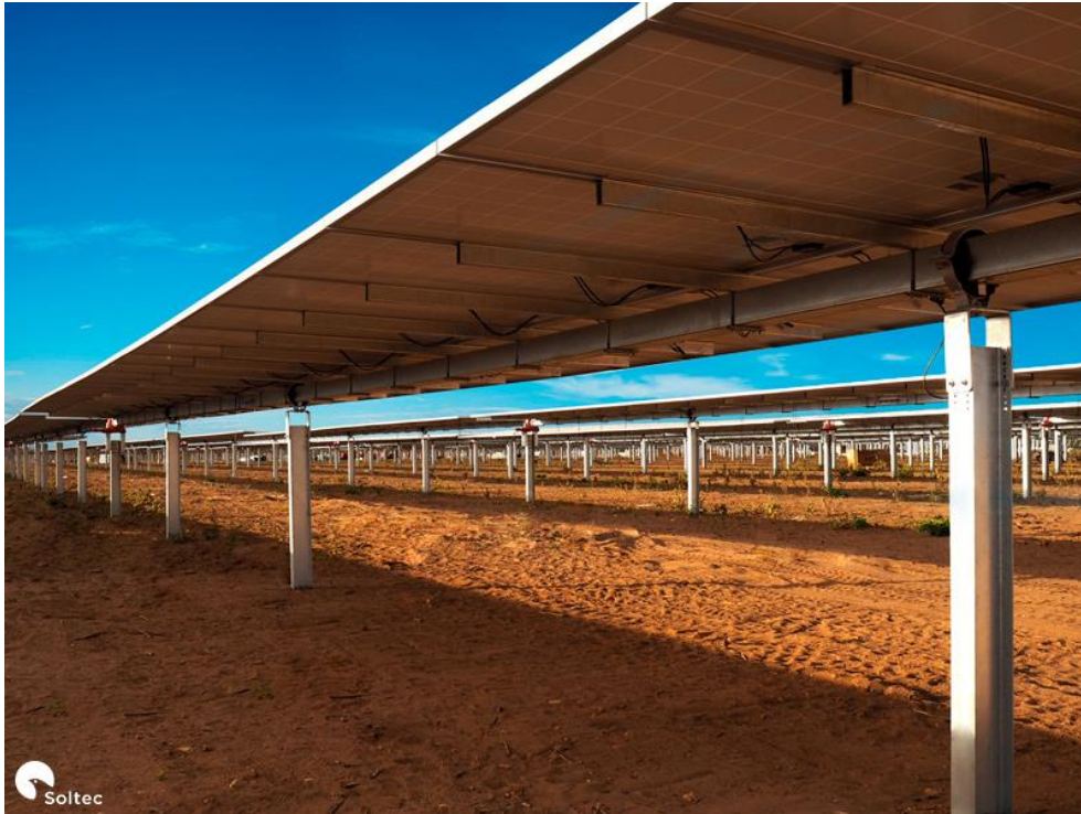
Figura 28: Solar Tracker montado en la planta Floresta de Brasil (Proveedor de Solar Trackers, s.f.).
