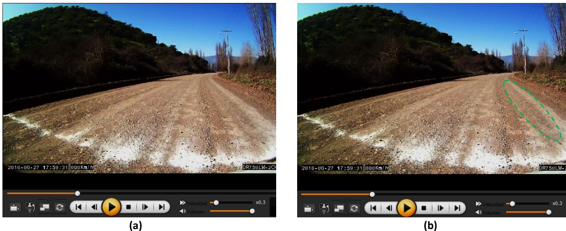
Figura 4-25: “Ahuellamiento CAM ” detectada como de nivel “Leve” con valor 1 cm de profundidad (fuente: propia) (a) Imagen sin demarcar ahuellamiento; (b) Imagen con ahuellamiento demarcado.
