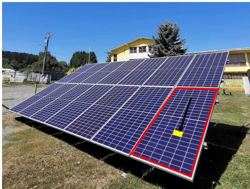
Figura N°5: Conjunto de Paneles Solares. En dicho conjunto, el rectángulo marcado con rojo representa un Panel Solar, por lo que en la figura se aprecian 14 Paneles Solares.
