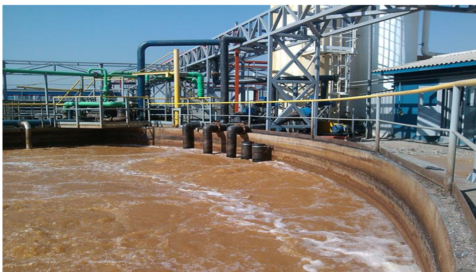
Figura 12: Estanque ecualizador de aguas contaminadas de industria papelera. Fuente: Celulosa Arauco, 2014.
