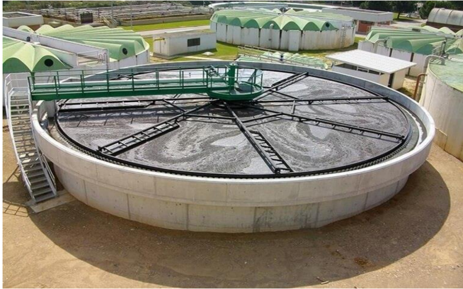
Figura 15: Celda de flotación empleada en el tratamiento de efluentes.
