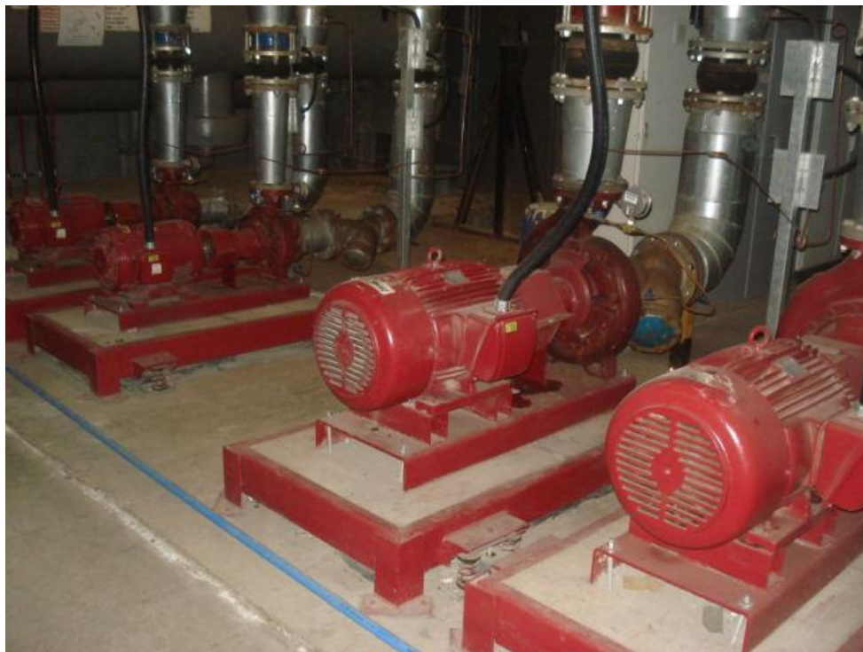
Fotografía 2: Bombas de climatización.
