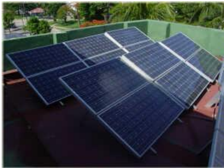
Figura 10: Sombra sobre paneles fotovoltaicos.
