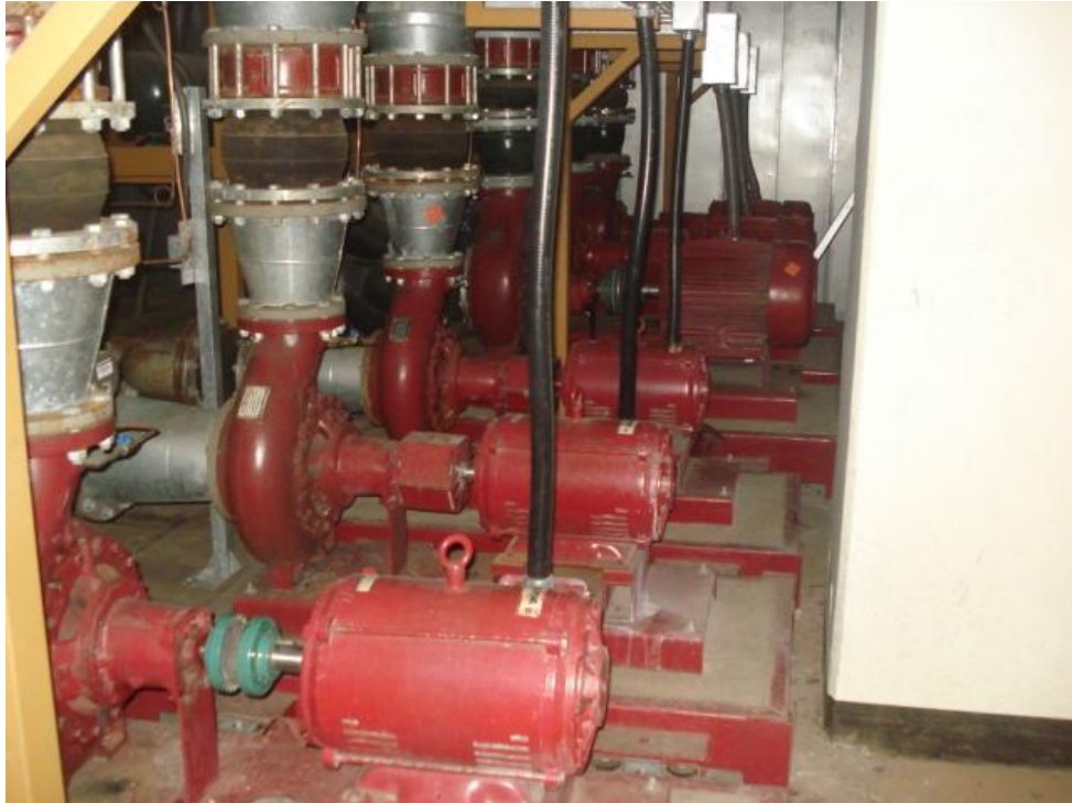
Fotografía 3: Bombas de climatización.
