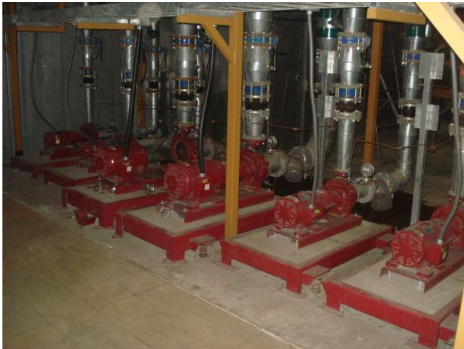
Fotografía 4: Bombas de climatización.
