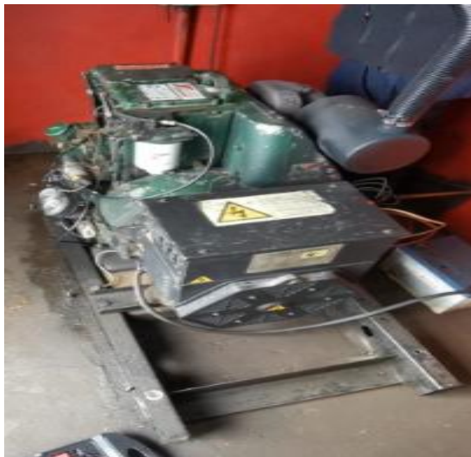
Figura 1.1: Grupo electrógeno ubicado en Planta Receptora Quiriquina.
