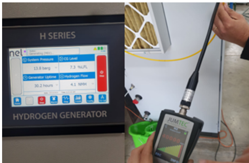
Figura 2.8: Imagen de panel del electrolizador produciendo hidrogeno por primera vez y mediciones de hidrogeno a la salida del interfaz “H2 Product”.
