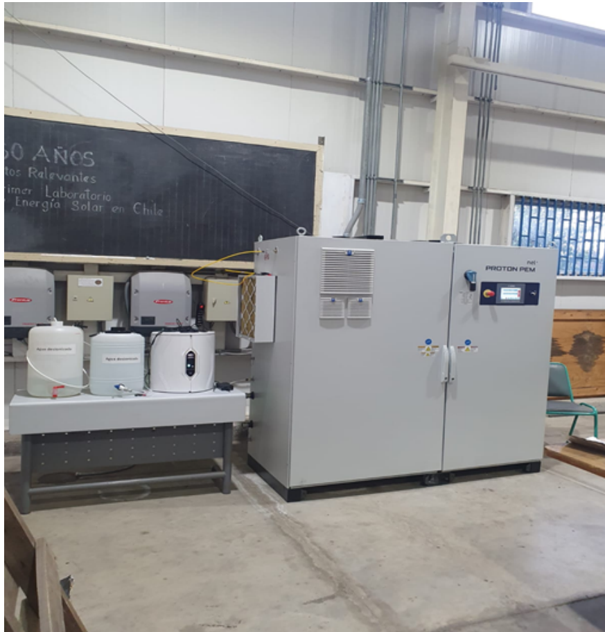
Figura 2.9: Instalación final del electrolizador luego de la puesta en marcha y toma de muestras.
