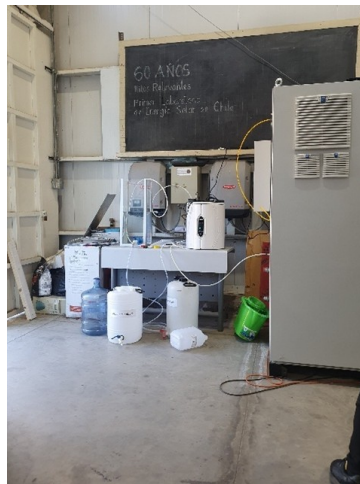
Figura 2.7: Imagen final de instalación de electrolizador PEM H4 Series Nel.
