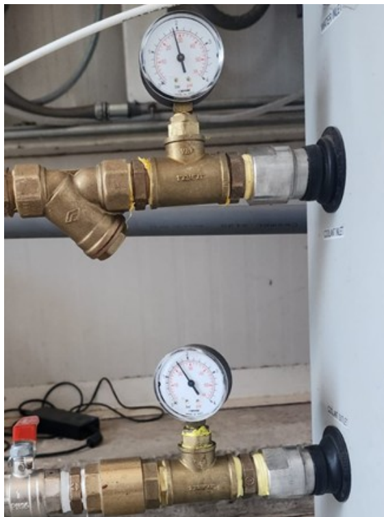
Figura 5.13: Imagen presión de agua de sistema de refrigeración a la entrada del electrolizador.
