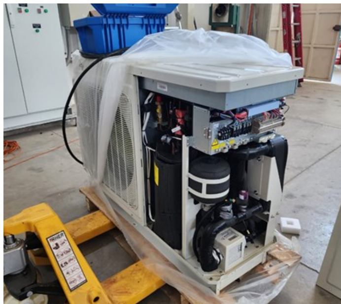
Figura 5.5: Bomba de calor desmontada parcialmente.
