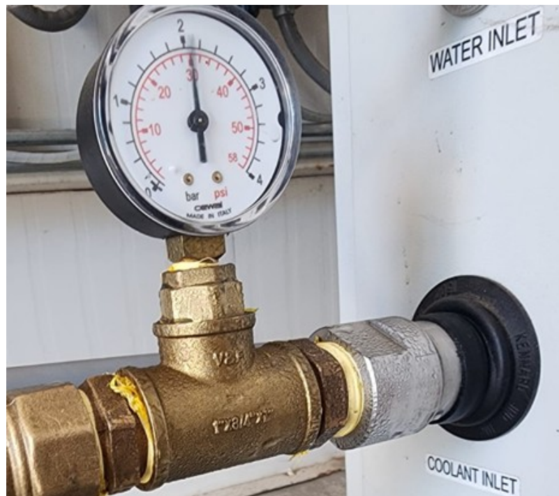
Figura 5.24: Condensado de agua dentro de conexiones de agua de refrigeración a la entrada del electrolizador.
