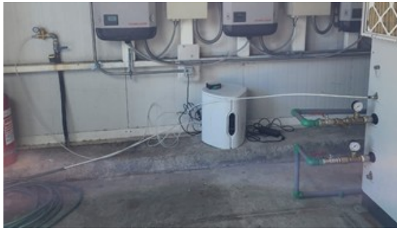
Figura 5.12: Imagen sistema de purificación de agua desionizada para electrolizador.
