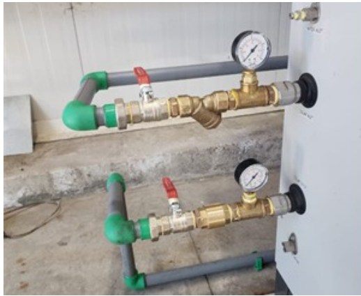
Figura 5.3: Imagen de kit de conexiones del líquido refrigerante al electrolizador.
