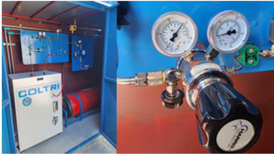
Figura 5.17: Imágenes del sistema de almacenamiento y compresión.
