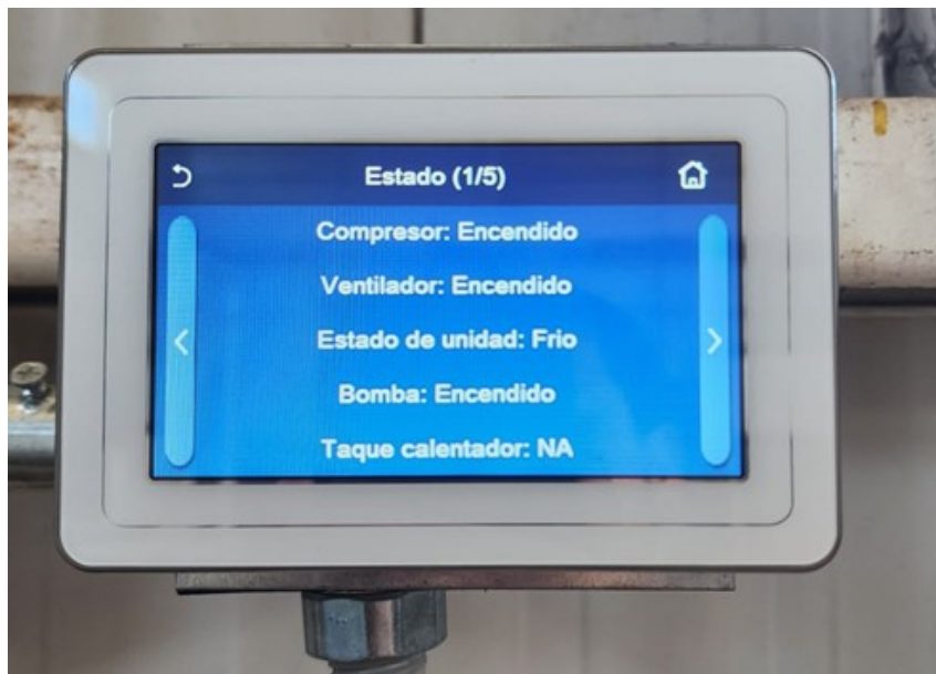
Figura 5.14: Imagen de señales entregadas por el panel de control.
