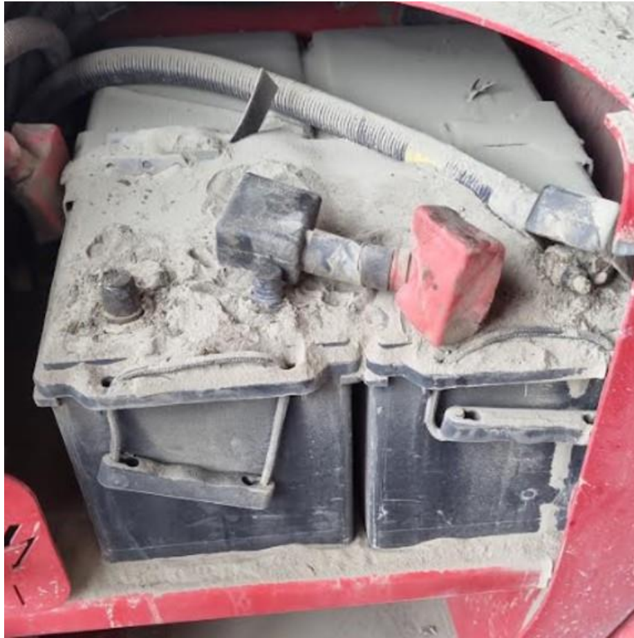
Figura 1.7: Baterías afectadas por acumulación de polución.
