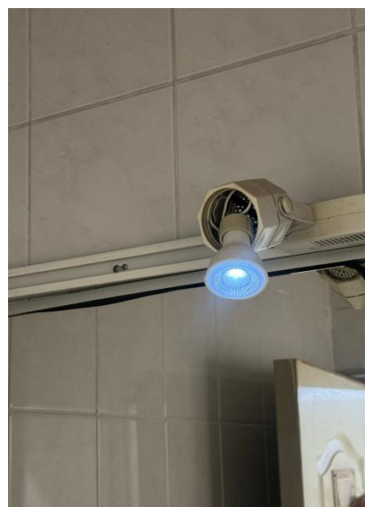
Fig. 1.4 Luminaria sin protección y conductores expuestos en área húmeda.
