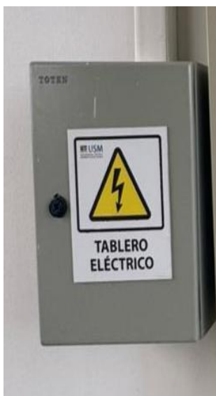
Fig. 1.2 Tablero Eléctrico Edificio Daniel Alkalay.
