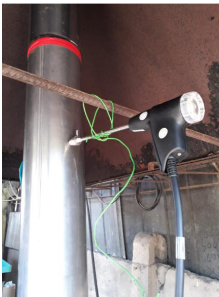
Figura 30: Sonda TESTO 350 instalada en ducto de escape.
