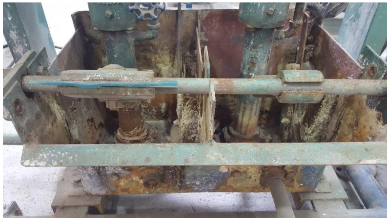
Figura 2- 3 Celda de Flotación en Estado Original
