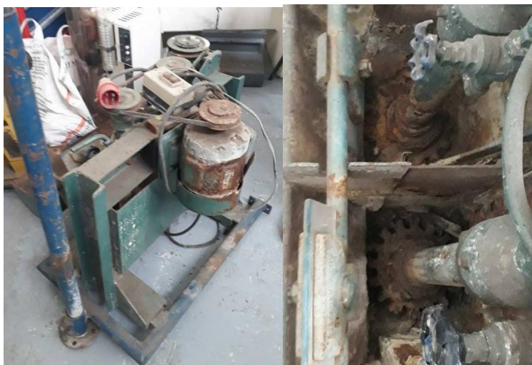
Figura 1- 8 Deterioro de Celda de Flotación
