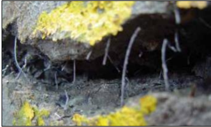
Ilustración N°1: Interior de la fisura ( “Hormigón reforzado con fibras” SikaFiber, Colombia ).
