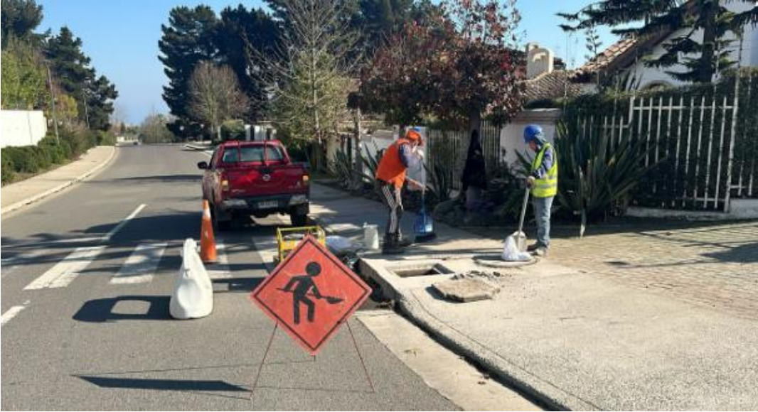
Imagen 38: Reposición de tapas y rejillas. Fuente: Elaboración propia inspección frente de trabajo.
