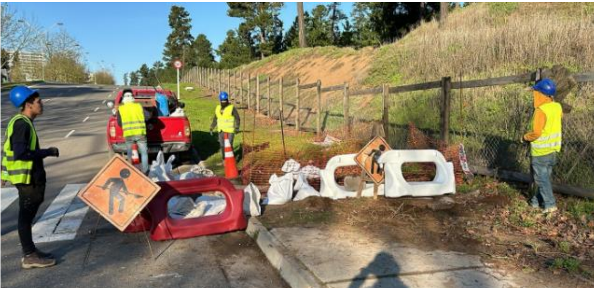
Imagen 39: Reposición de tapas y rejillas. Fuente: Elaboración propia inspección frente de trabajo.
