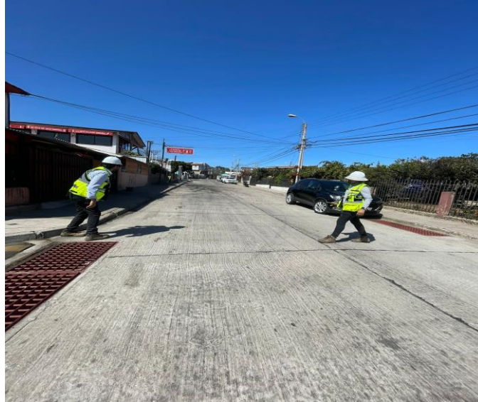
Imagen 33: Sumidero Longitudinal 7 metros.
