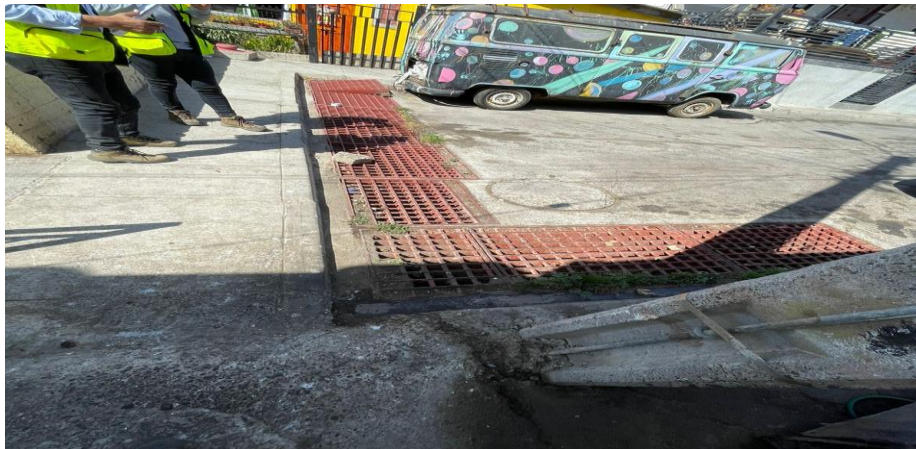
Imagen 34: Sumidero longitudinal 4 metros.
