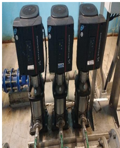
Figura 3-3: Bombas centrifugas multietapa. (Fuente: Sala de bombas HGGB)
