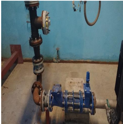
Figura 3-7: Circuito piping. (Fuente: Sala de bombas de HGGB)
