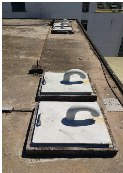
Figura 3-2: Estanques cisterna. (Fuente: Edificio monoblock HGGB)
