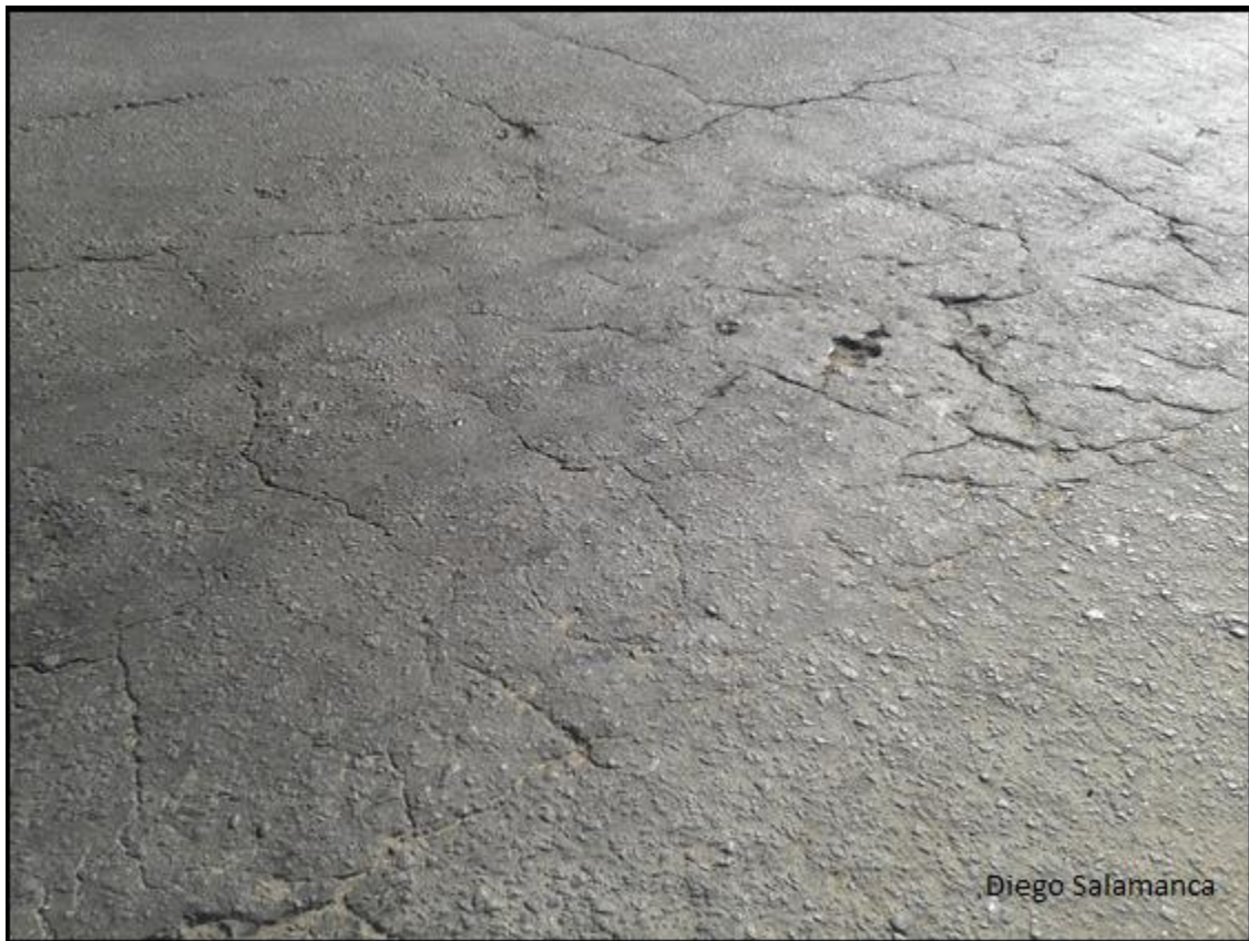
Figura 2-3: Pavimento con deterioro por fatiga
