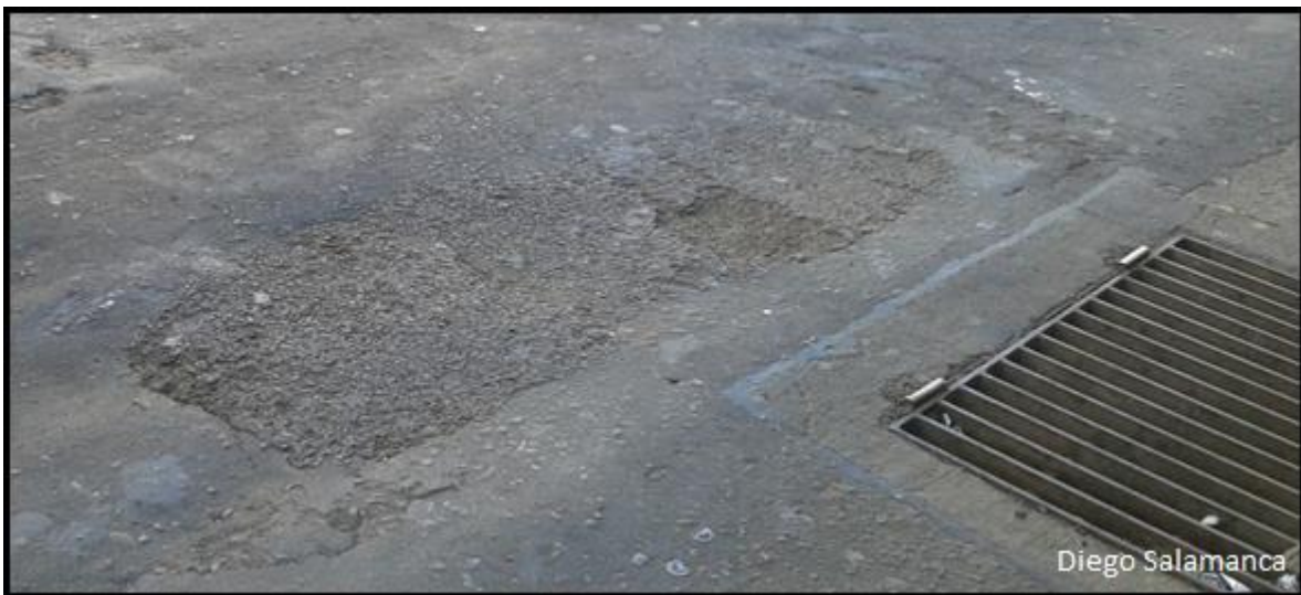
Figura 2-5: Pavimento con deterioro por desprendimiento de los agregados
