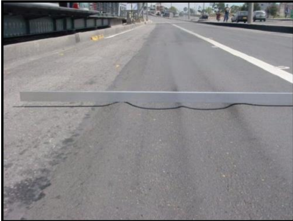
Figura 2-4: Pavimento con deterioro por ahuellamiento [5]
