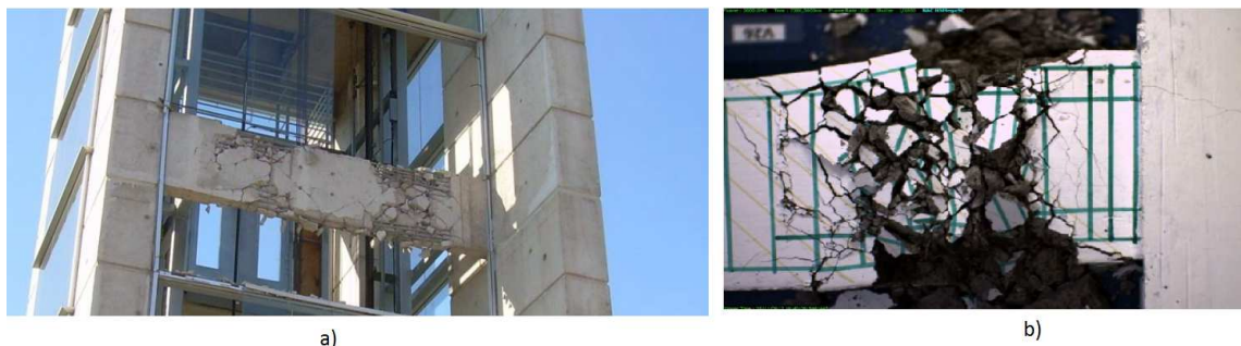
Figura 1.1. (a) Torre del ascensor aeropuerto dañada durante terremoto 2010 (Schnaidt 2010). (b) Ensayos cíclicos llevados a cabo por M. Vergara. (Vergara 2014).
