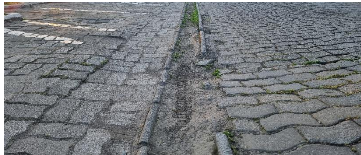
Ilustración 11 – Fotografía Cuneta existente. Fuente: Elaboración propia.
