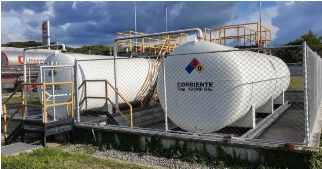
Fig. 2 9 Tanque Cilíndrico horizontal
