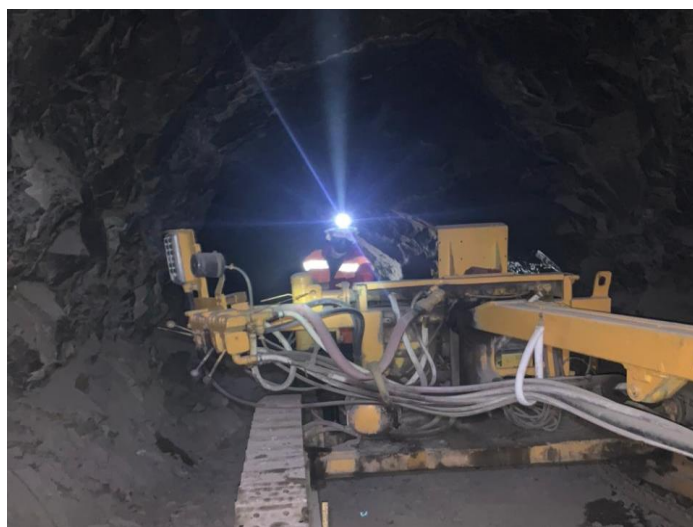
Ilustración 10: Captura imagen del equipo pilares de avance de minera la verdosa.
