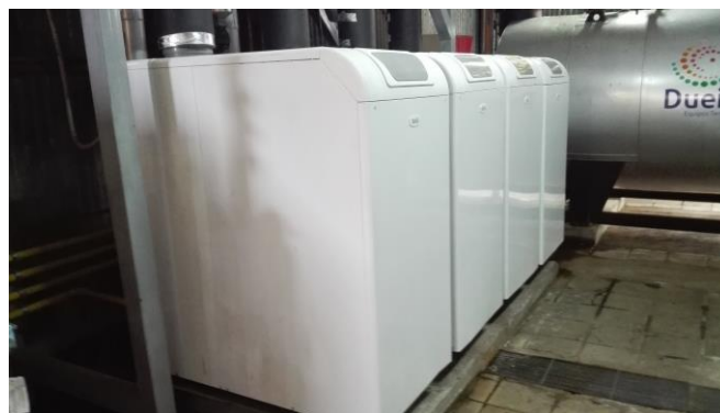
Figura 2-4: Calderas de condensación.
