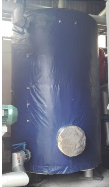
Figura 2-8: Estanque de inercia.
