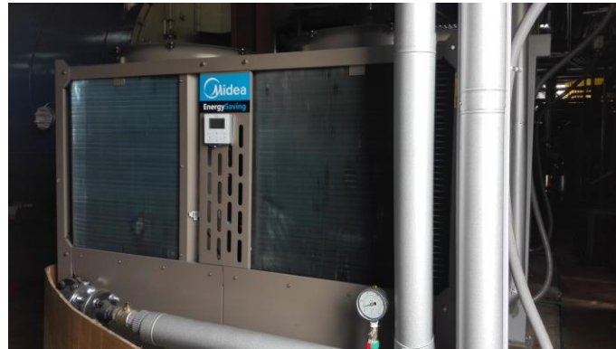
Figura 2-5: Bombas de calor
