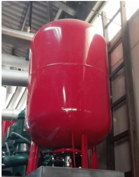
Figura 2-10: Estanque de expansión.
