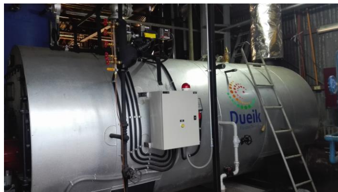
Figura 2-6: Caldera generadora de vapor.
