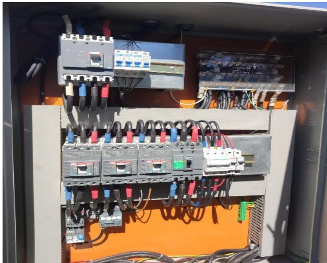
Figura 2-13. Tablero general eléctrico.
