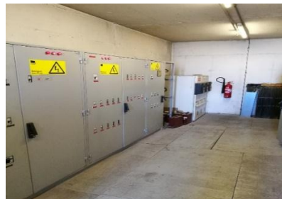
Ilustración 31: Cuarto de los elementos eléctricos del Mall ubicado en el Techo. Fuente: Registro propio.
