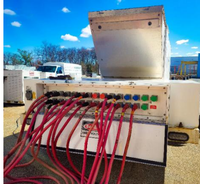
Figura 6. Banco de carga utilizado para pruebas de generadores de alta tensión
