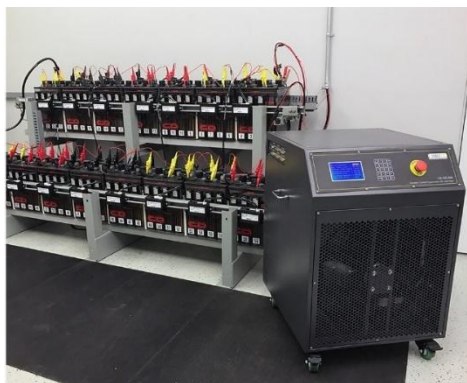
Figura 5. Banco de carga resistivo utilizado para pruebas de descarga en baterías estacionarias.
