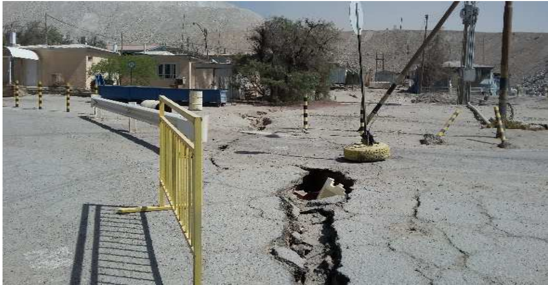
Ilustración 3.4-4 Imágenes de grietas a 200 metros del borde del Rajo Chuquicamata Norte (01-2016)
