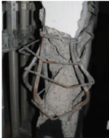
Figura 1.2: Falla en plano diagonal producida luego del terremoto de Maule de 2010 (Hube & de la Llera, 2015)
