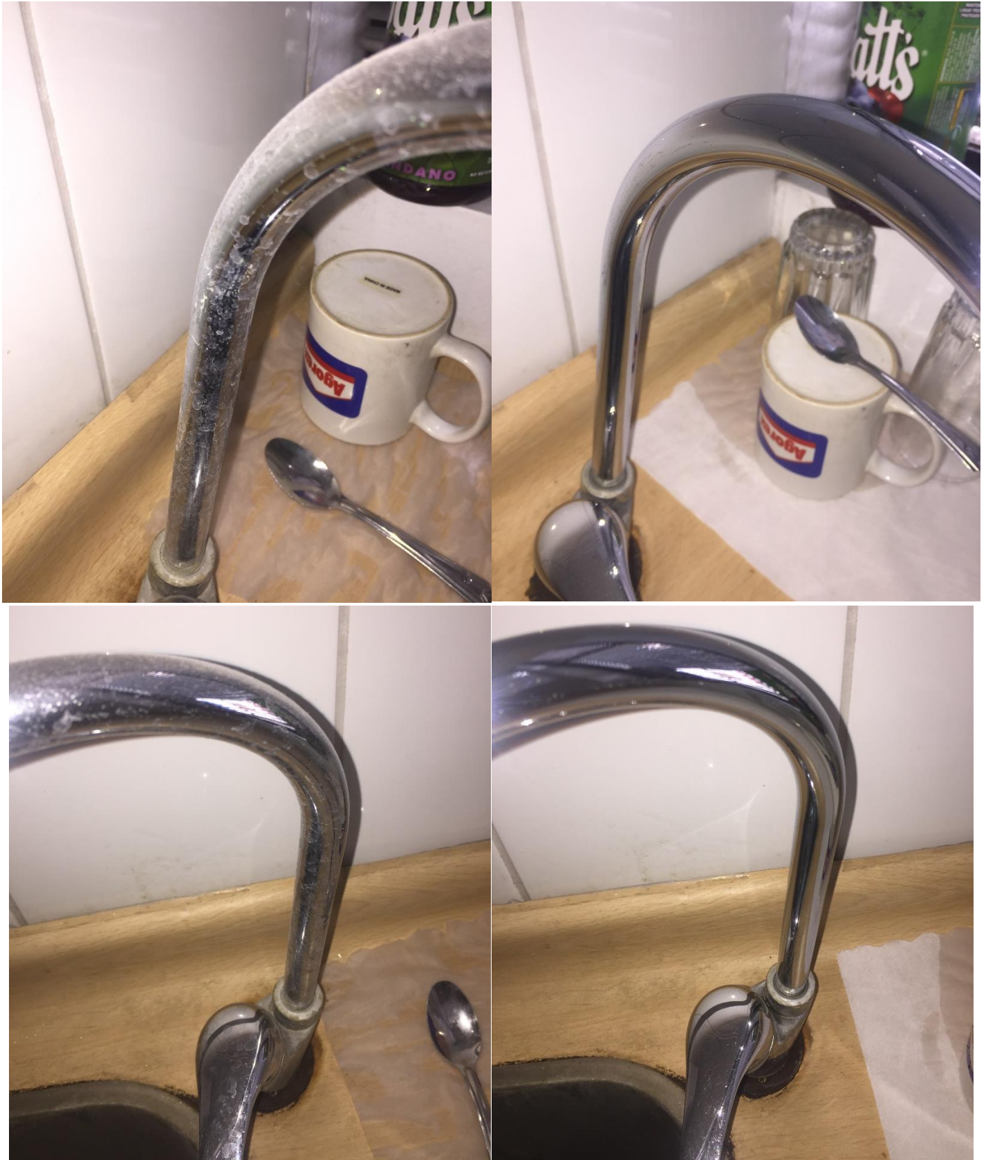
Imagen 23: Comparación antes (izquierda) y después (derecha) de la limpieza, en la tubería de salida de la grifería, del sector para café de las oficinas.
