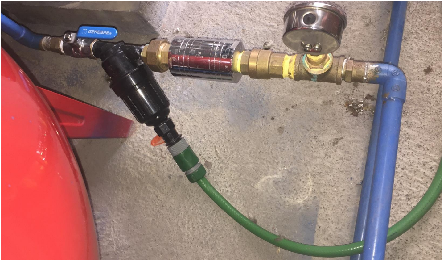
Imagen 3: Acelerador iónico instalado.
