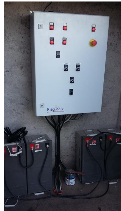
Imagen 4.3 Equipo de control mando local
