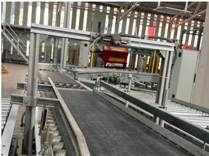
Figura 2-3: Lector Código de Barras (Distribuidor de Cajas Paletizado)
