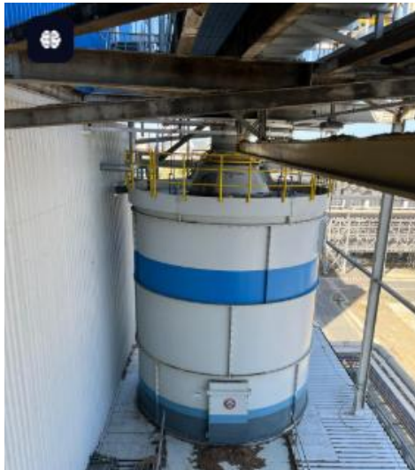
Figura 2-12: Silo de almacenamiento de caldera de poder.
