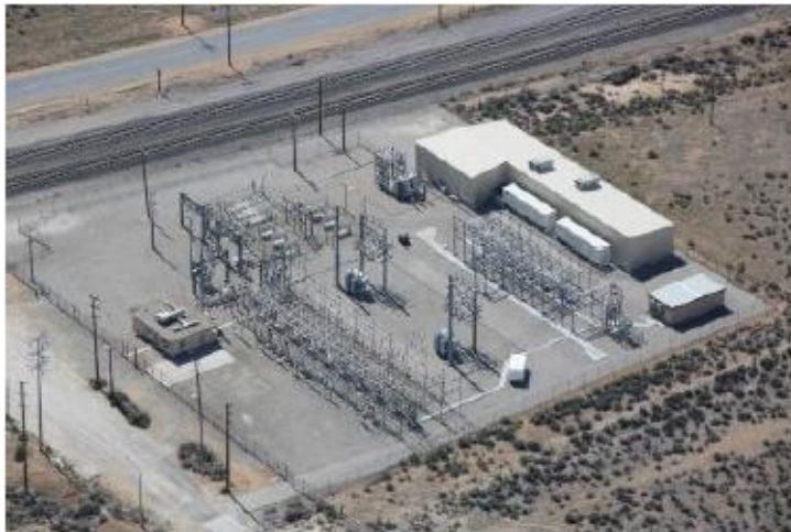
Figura 8: Instalaciones del área de almacenamiento y de la subestación
