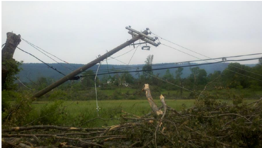
Figura 6: Daño en las líneas provocado por la tormenta de abril de 2011
