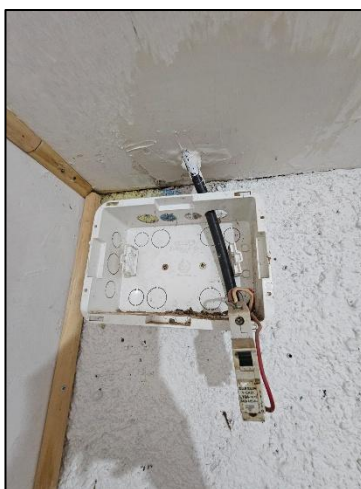
Fuente: Elaboración propia. Figura 1-7 Tablero eléctrico existente.
