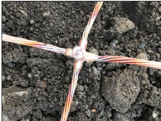
Fuente: Elaboración propia. Figura 2-32 Unión exotérmica tipo Cadweld.
