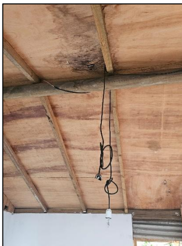
Fuente: Elaboración propia. Figura 1-12 Condición deficiente de luminaria.
