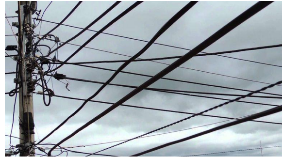
Figura 4. Conductores eléctricos. Fuente (La Nación, 2019)
