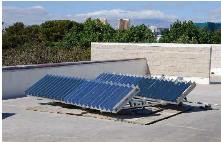
Figura 16: Concentrador solar fotovoltaico con seguimiento en un eje [18]
