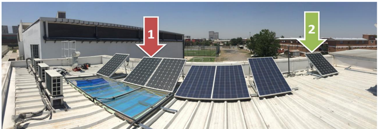
Figura 38: Instalación modificada en techo edificio mecánica, campus San Joaquín
