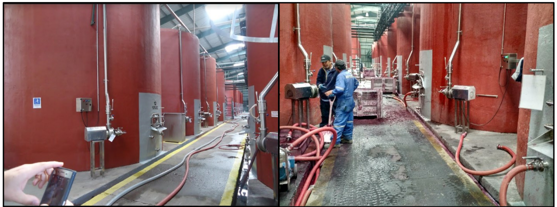
Figura 6: Fotografía - canales de RIL en zona de cubas de producto.
