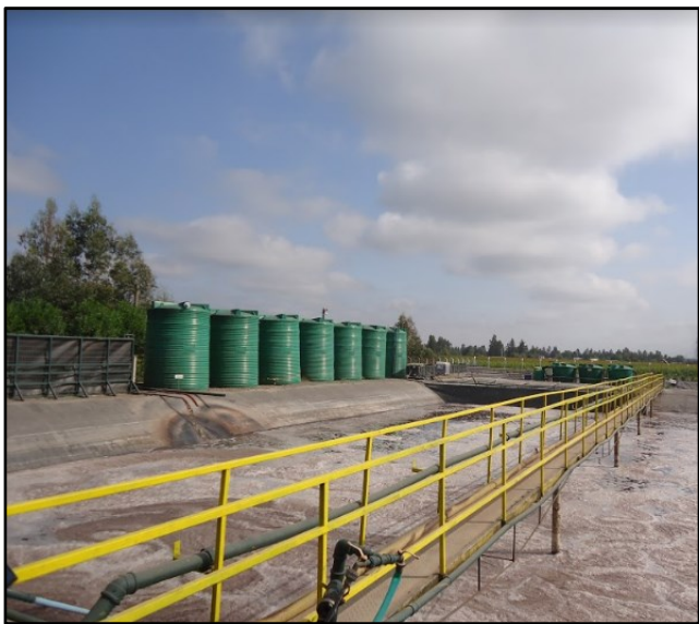
Figura 17: Fotografía - Piscinas de recepción final para RIL.
