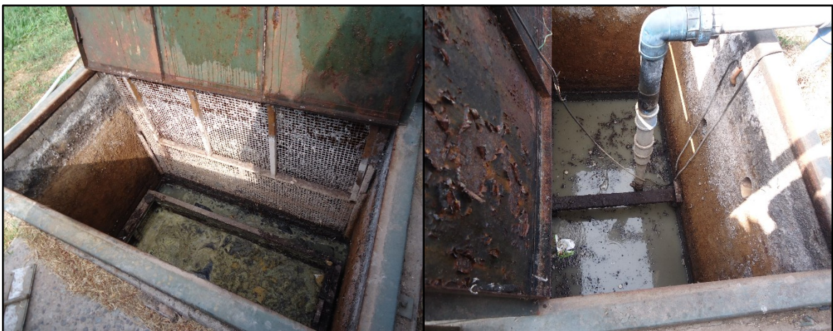
Figura 15: Fotografía - Pozos filtradores de tercer orden.
