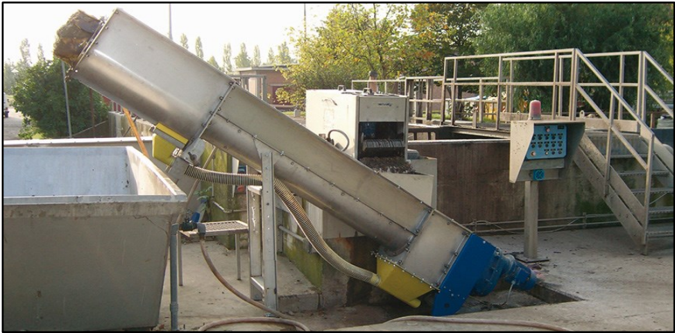
Figura 32: Tornillo sin fin compactador de sólidos. (NUTECO, 2019)
