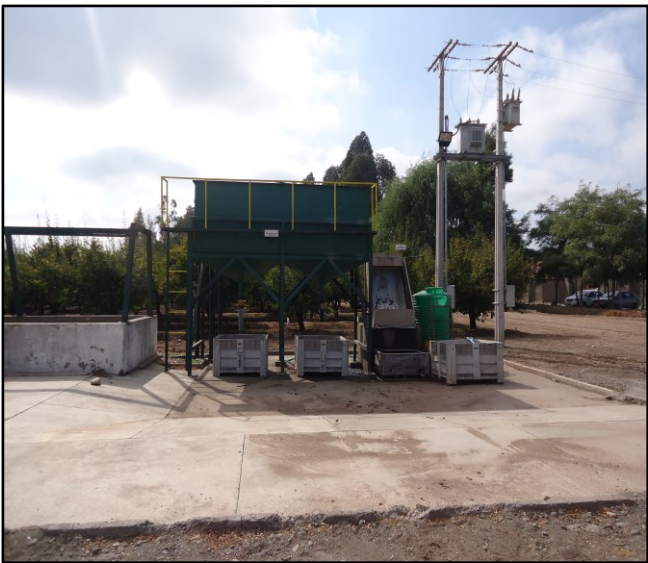
Figura 16: Fotografía - Estación de filtro parabólico.
