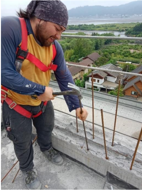
Anexo 1: Instalación de enfierradura para encofrado, con evidente negligencia del trabajador al no usar sus elementos de protección personal.
