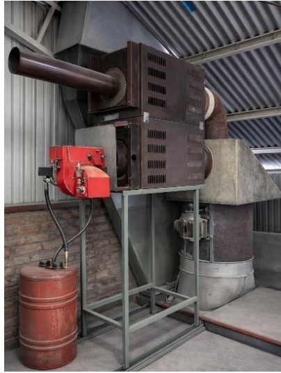
Imagen 13: Sistema de calefacción Fuente: Elaboración propia
