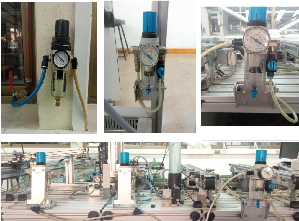
Ilustración 17: Válvulas de paso y decantadores
