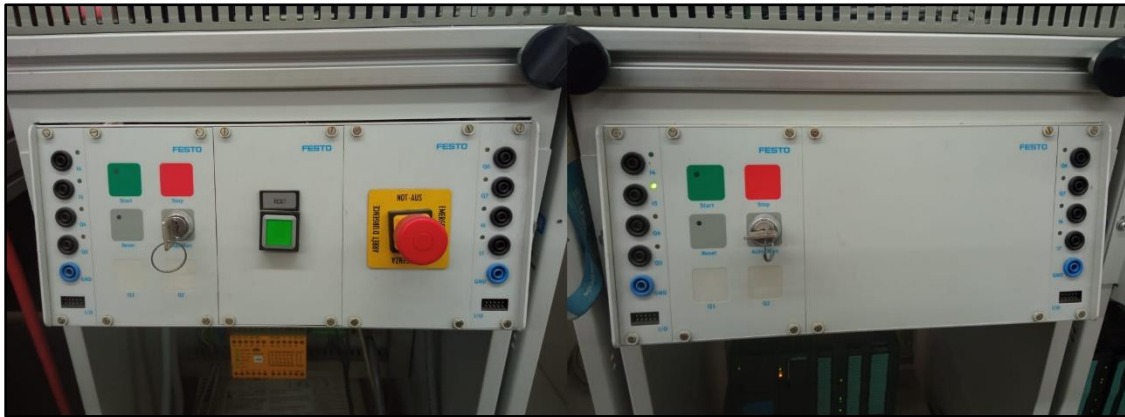
Ilustración 98: Panel de control Brazo y Estación 1
