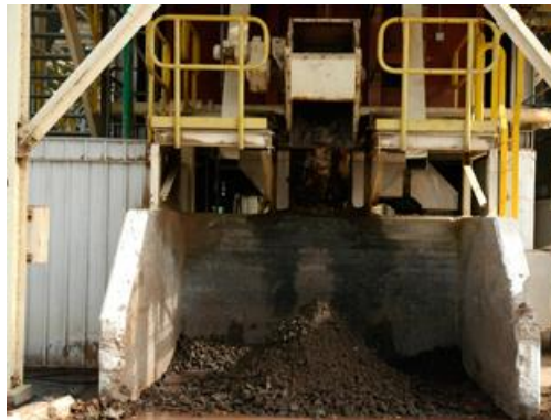
Figura 20. Chute para eliminación de escorias y cenizas (Riquelme A., Figura de chute para eliminación de escorias, 2024)
