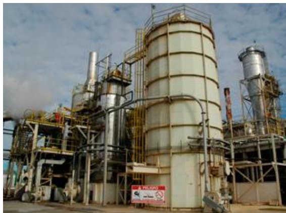
Figura 16. Planta de Generación de Energía (Planta Térmica)
