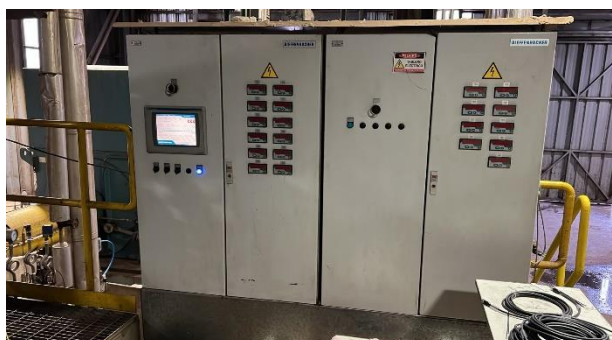
Figura 47. Controlador Lógico Programable (Riquelme A., Figura de PLC, 2024)
