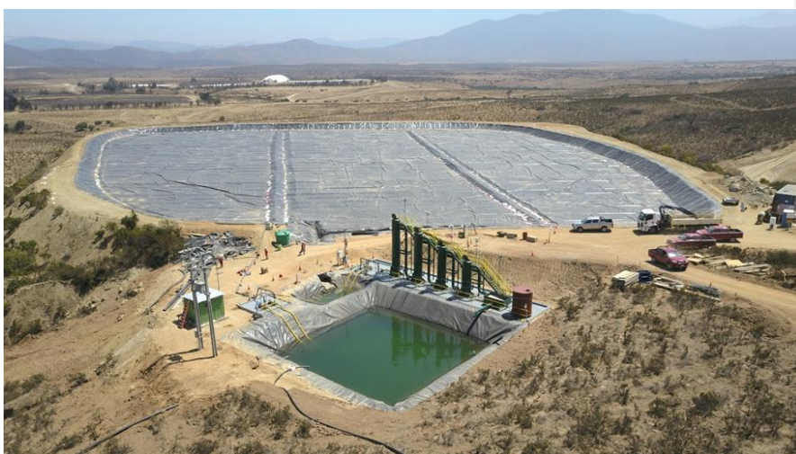
Ilustración 1-3, Planta Piloto de aglomerado y lixiviación en pilas
