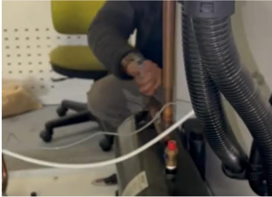
Figura 21: Válvula de entrada tanque receptor en proceso de cierre.
