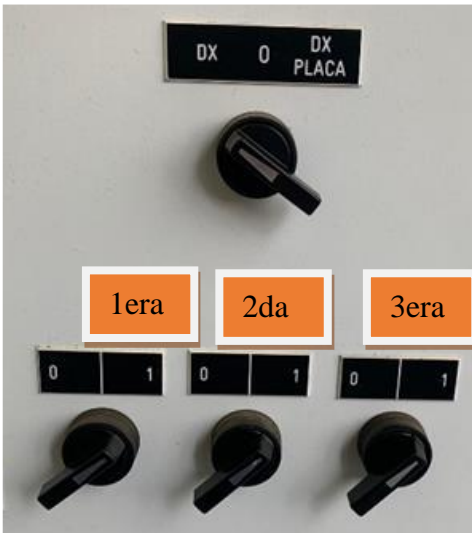
Figura 18: Interruptor expansión directa e interruptores etapas de calefacción.
