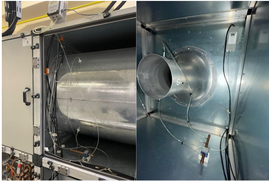
Figura 17: Cámara receptora y tobera de descarga con puntos de medición y transmisor de presión diferencial.
