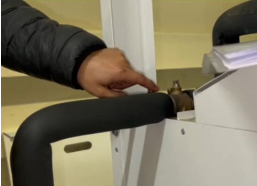
Figura 22: Válvulas de bola de líneas de refrigerante en proceso de cierre.
