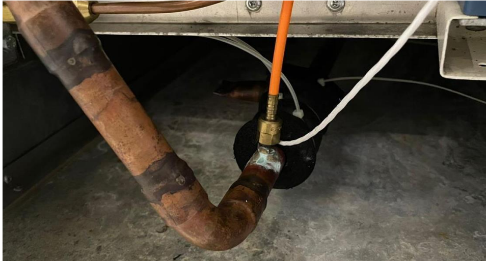
Figura 12: Transmisor de temperatura junto con la tubería de cobre.
