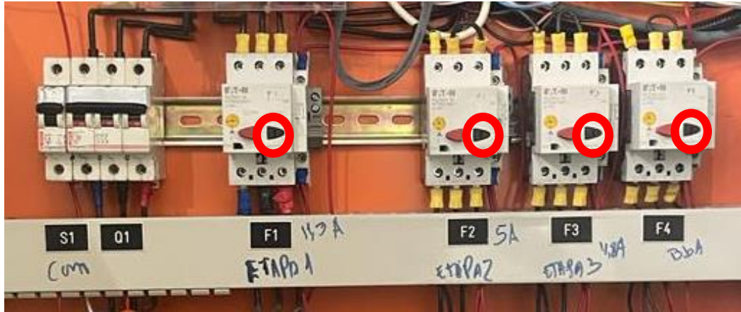
Figura 23: Interruptores de apagado etapas de calefacción.
