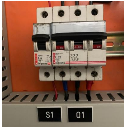
Figura 16: Interruptores, S1 monofásico, Q1 trifásico.
