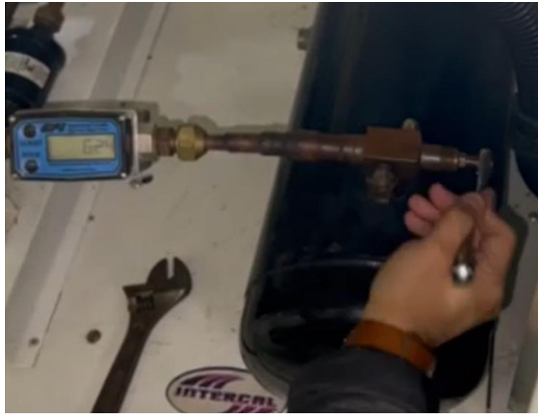
Figura 19: Válvula descarga tanque receptor.
