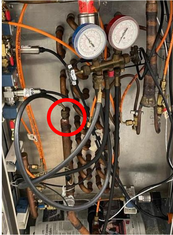
Figura 3.7: Conexión manómetro en colector.
