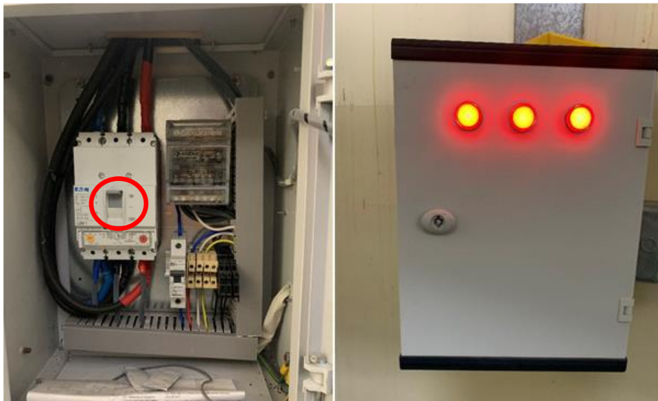
Figura 1: Tablero de Energía principal
