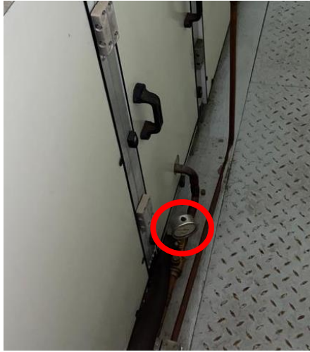
Figura 3.8: Manómetro de glicerina posterior al evaporador, en la línea exterior del túnel.
