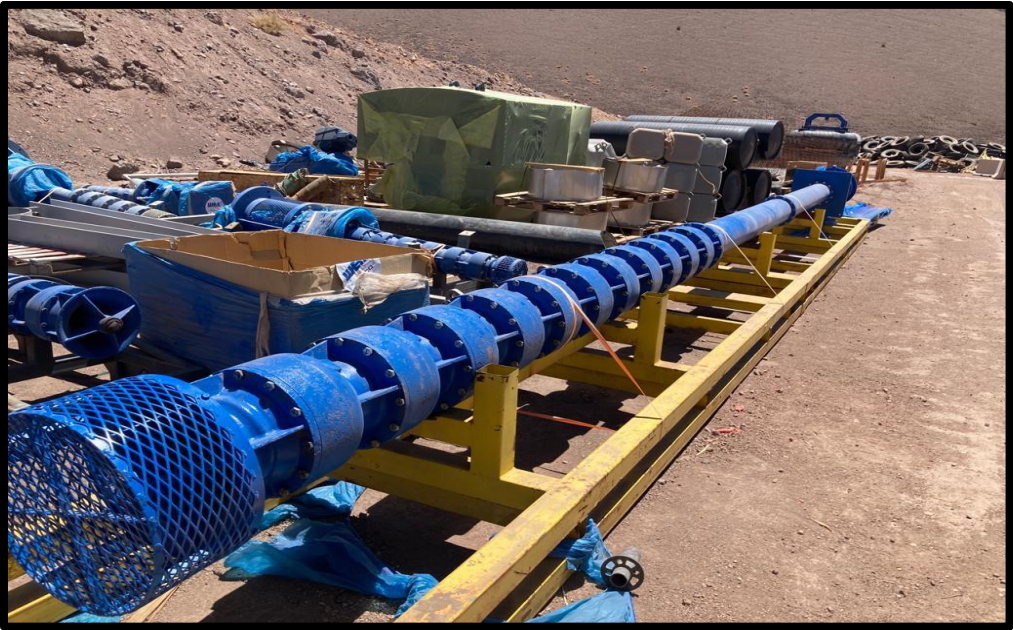
Figura 1-9: Largo de bombas verticales
