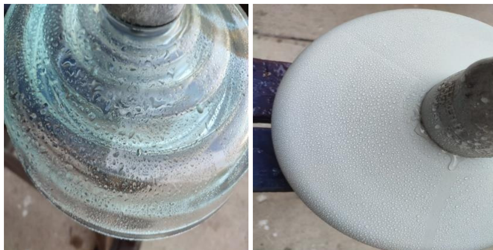
a) Aislador sin recubrimiento.
