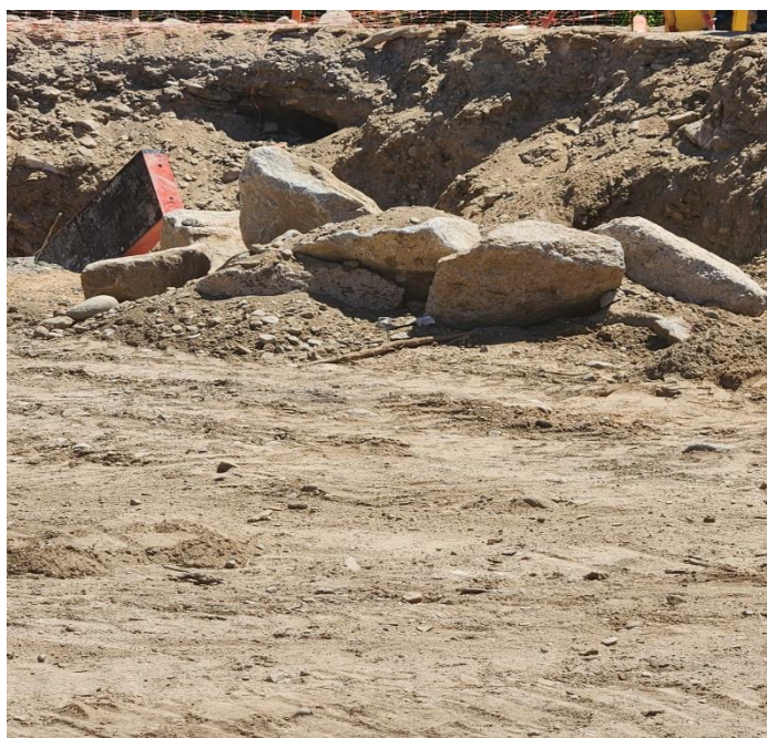
Figura 4.2. Disposición de residuos de construcción en el área de trabajo sin segregación definida. Fuente: Elaboración propia a partir de observación en obra (2025).
