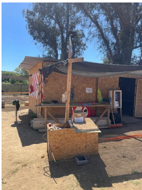
Figura 4.3. Área de almacenamiento de materiales sin señalética ni delimitación de acopio.
